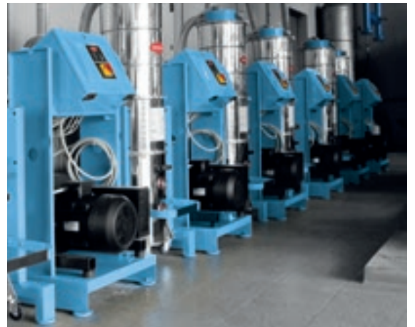
Claws suction units in battery. Bateria de bombas com rotor com pás tipo garra.
